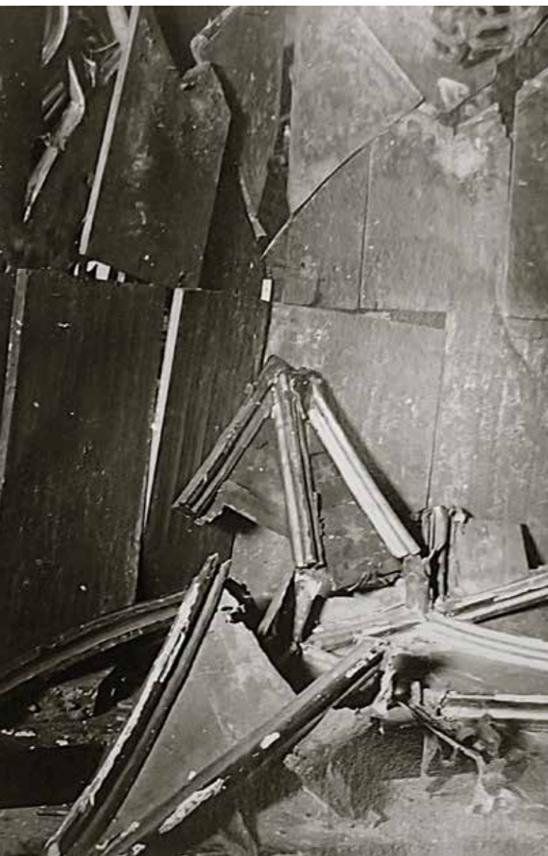
Obr. 11 Košice, hlavní oltář sv. Alžběty, klenba jednoho z baldachýnů z ústřední skříně, stav před restaurováním, 50. léta; Archiv PÚSR, R 81.
